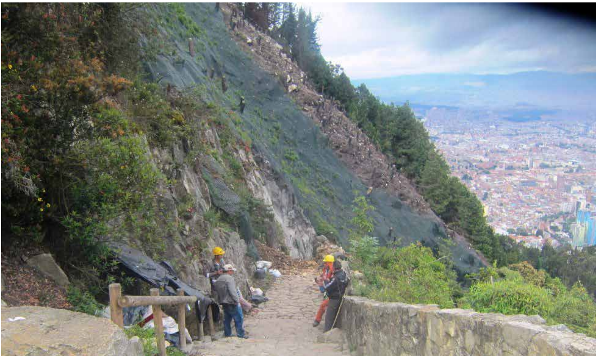
Esperando a los ingenieros y funcionarios del del Instituto Distrital de Recreación y Deporte (IDRD). Las obras se encuentran paralizadas. Foto Primicia
