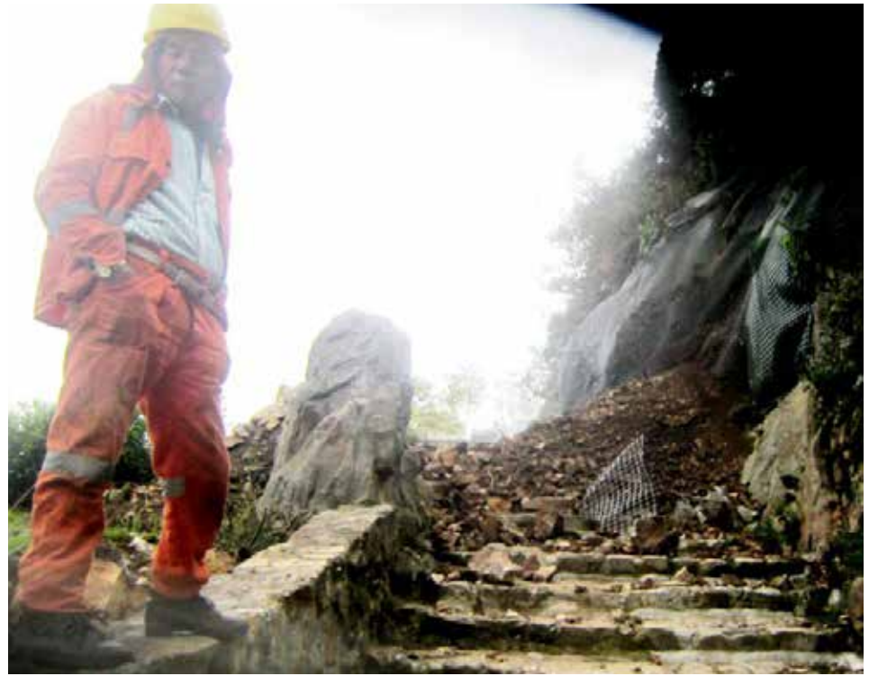
Un obrero es el encargado de evitar que deportistas suban por el camino peatonal ante los derrumbes que se vienen presentando en la parte alta de la montaña.
