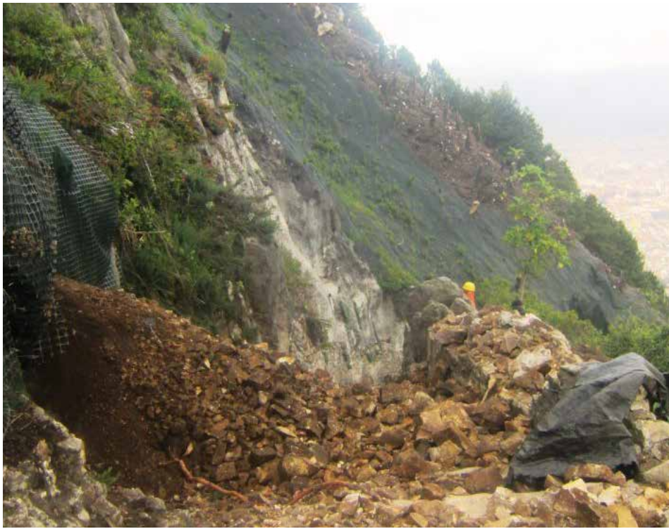
Obreros que adelantan desde el lunes actividades en el cerro de Monserrate, tuvieron que suspender sus labores ante el derrumbe de piedras en el sendero peatonal. Foto Primicia
