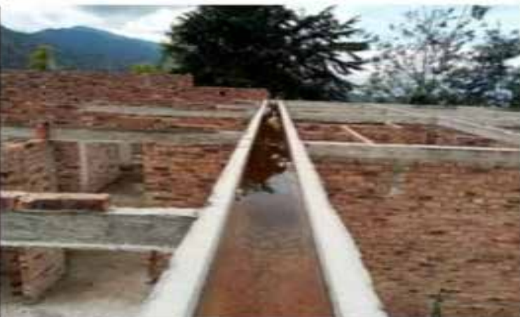
No se evidencia cubierta.
