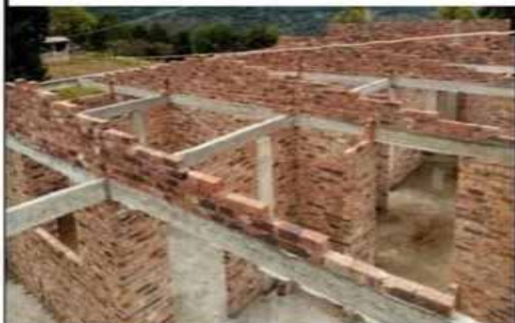
No se evidencia cubierta.
