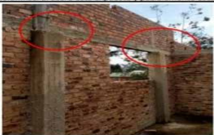
Como se evidencia en esta y otras fotografías al parecer faltan vigas aéreas que amarren el diafragma en sentido perpendicular al muro. Esta situación se repite en varios nudos.
