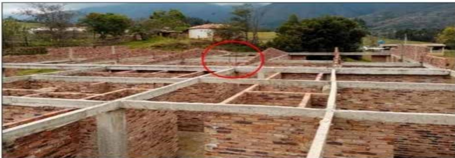
No se evidencia cubierta. No están construidos todos las culatas y las que están no se encuentran rematadas ni reforzadas.
