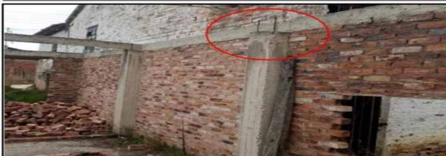
Se observan las columnas con diferentes tipos de secciones, más del 30% no cumplen con los mínimos requeridos en el Título C de la NSR-10. Adicionalmente la distribución no corresponde a un diafragma pensado para responder estructuralmente. Los nudos evidencian un amarre inadecuado entre los elementos vigas y columnas. El acero está expuesto y posiblemente escaso para los requerimientos mínimos de la norma.
