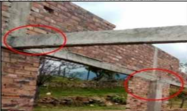
Nudo incorrecto, no cumple una función estructural. En la columna se observa una baja cuantía de acero respecto al concreto, lo cual le resta resistencia al pandeo lateral. No acorde con la Norma Técnica Colombiana NSR-10.
