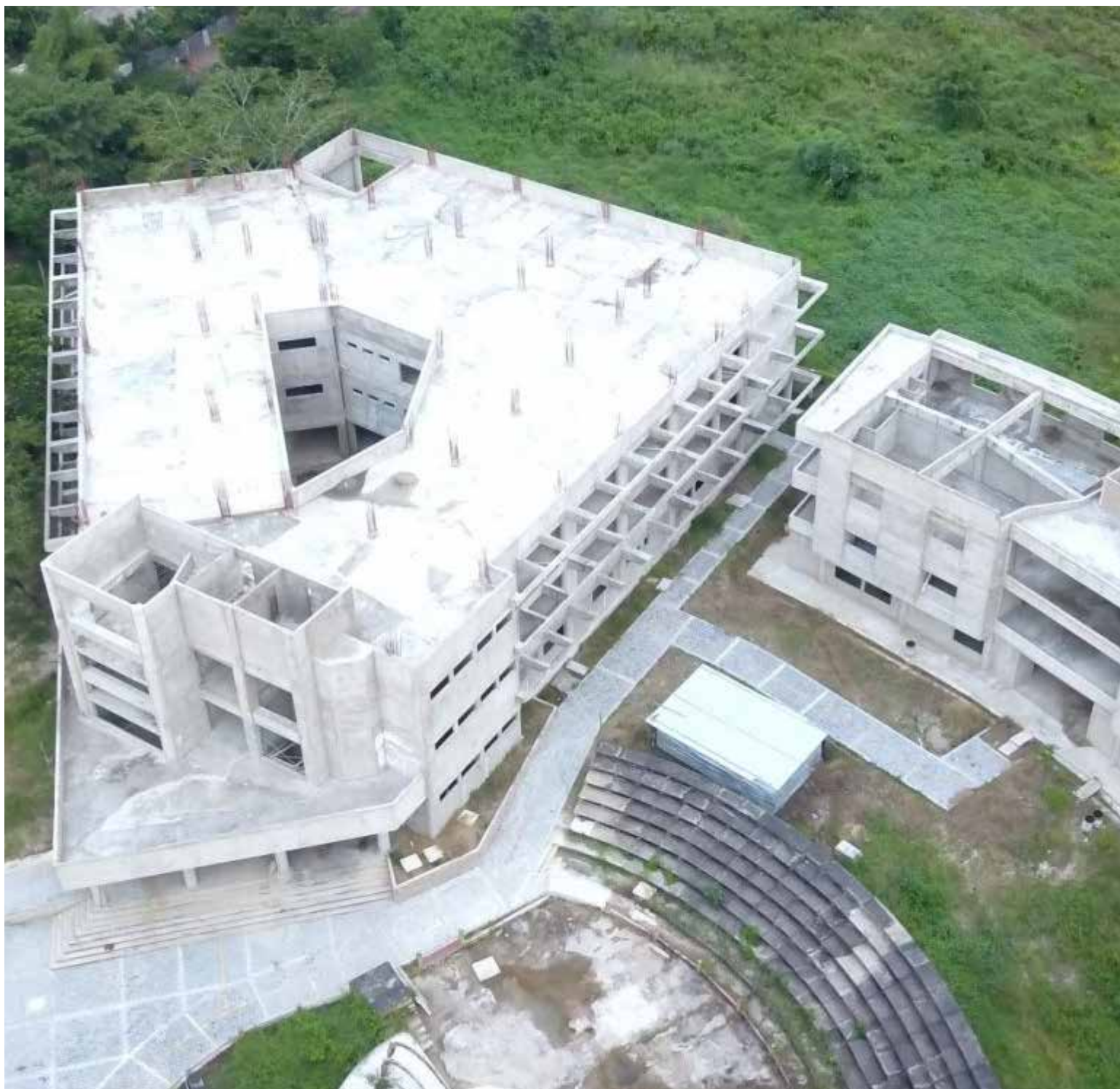
SEDE DE LA UNIVERSIDAD DE CÓRDOBA EN SAHAGÚN. SU CONSTRUCCIÓN INICIÓ EN 2015 Y NO HA SIDO ENTREGADA. CRÉDITO: LA LIGA CONTRA EL SILENCIO.
