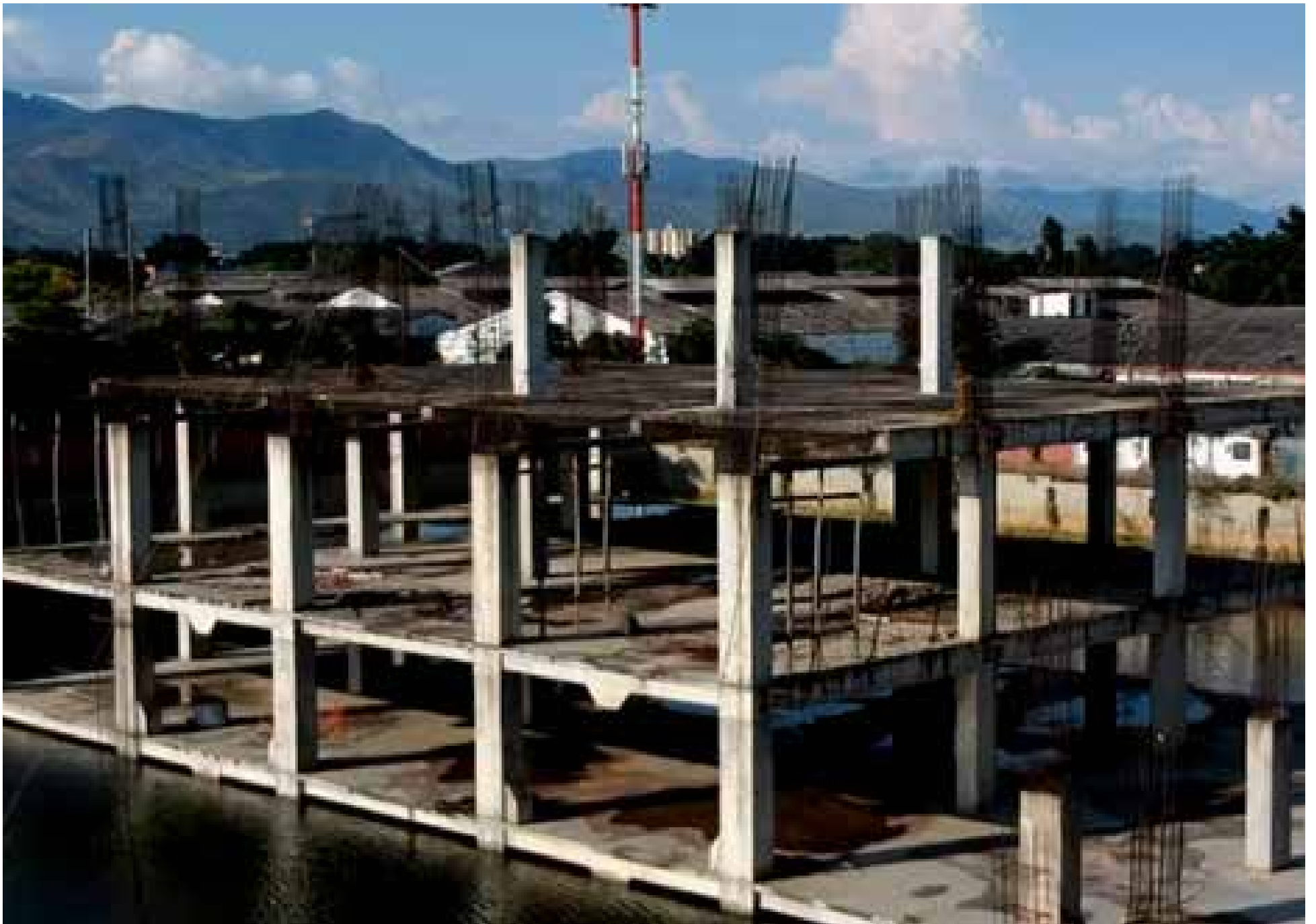
Esos miles de millones de pesos parece que hubiesen quedado perdidos en este proyecto en el cual cavaron las bases, iniciaron pilotaje, cimentación y no salió a flote.
