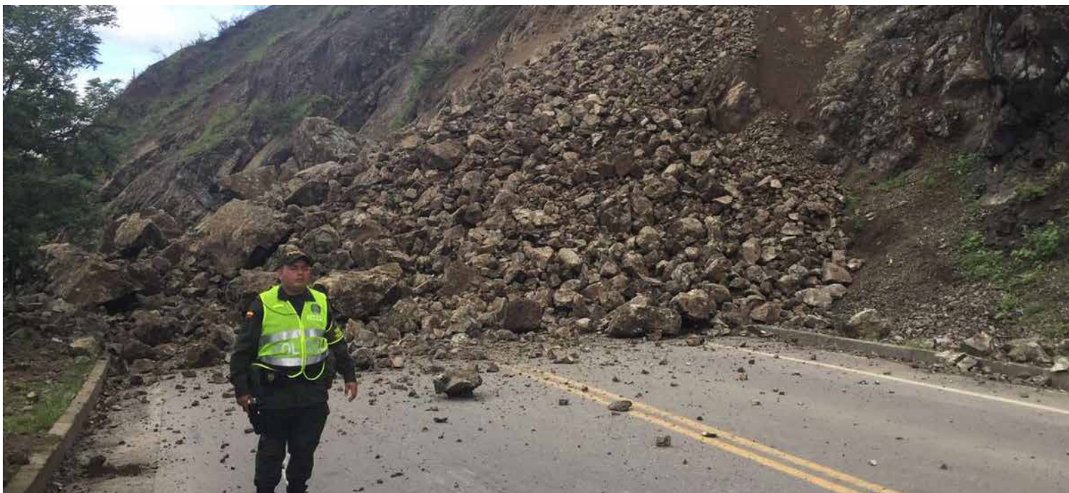
Los derrumbes y taponamientos son frecuentes en la vía Popayán-Pasto.
