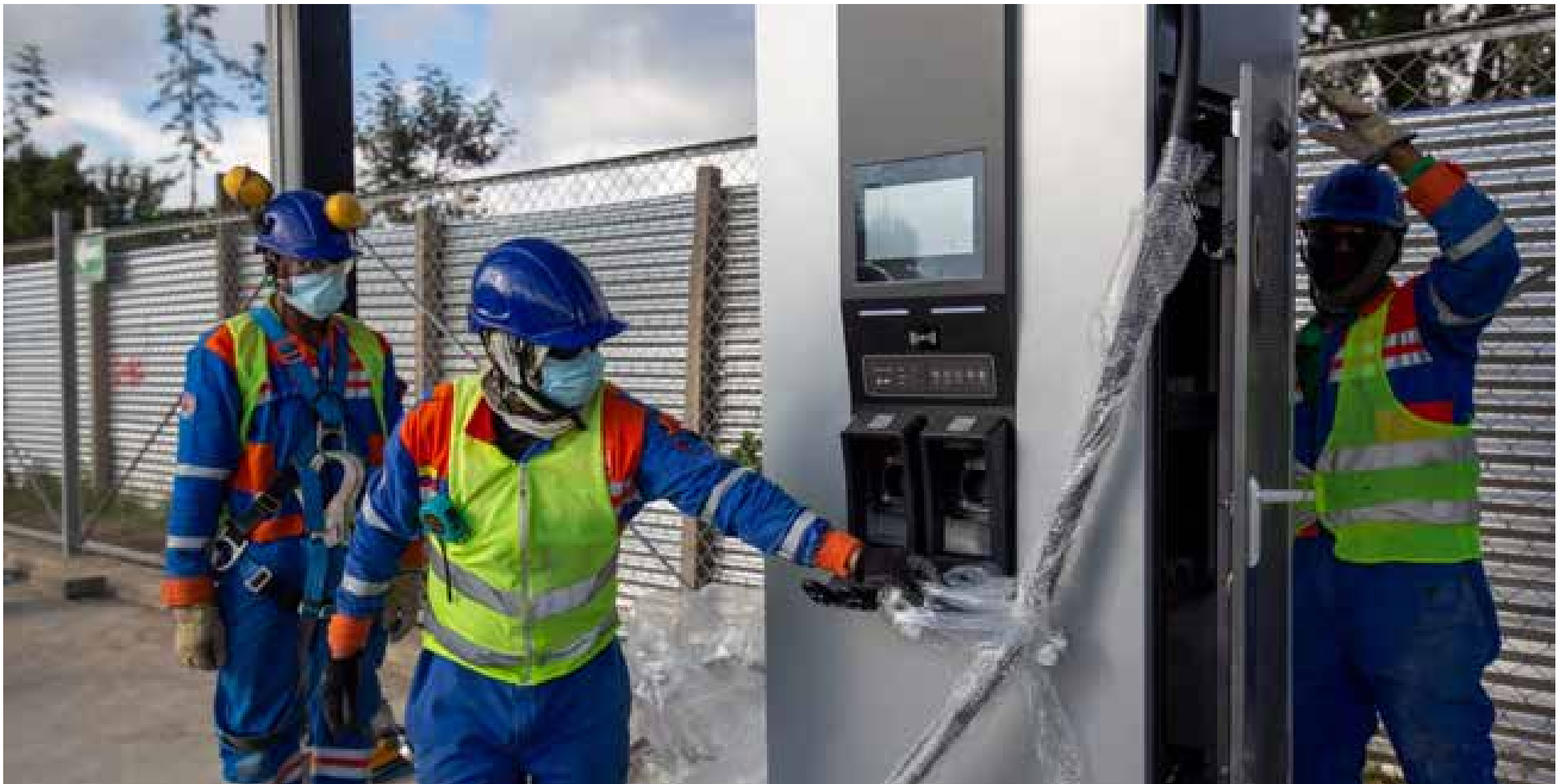
Maquinas de carga para electricidad.
