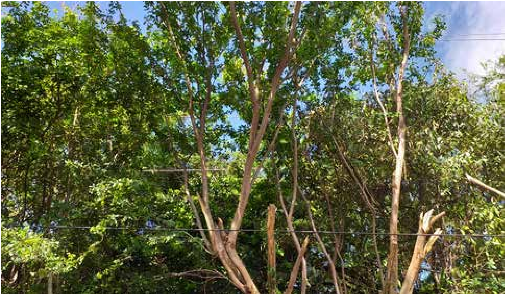
Las lluvias y los vientos han desplazado los cables ocasionando daños en la zona rural.
