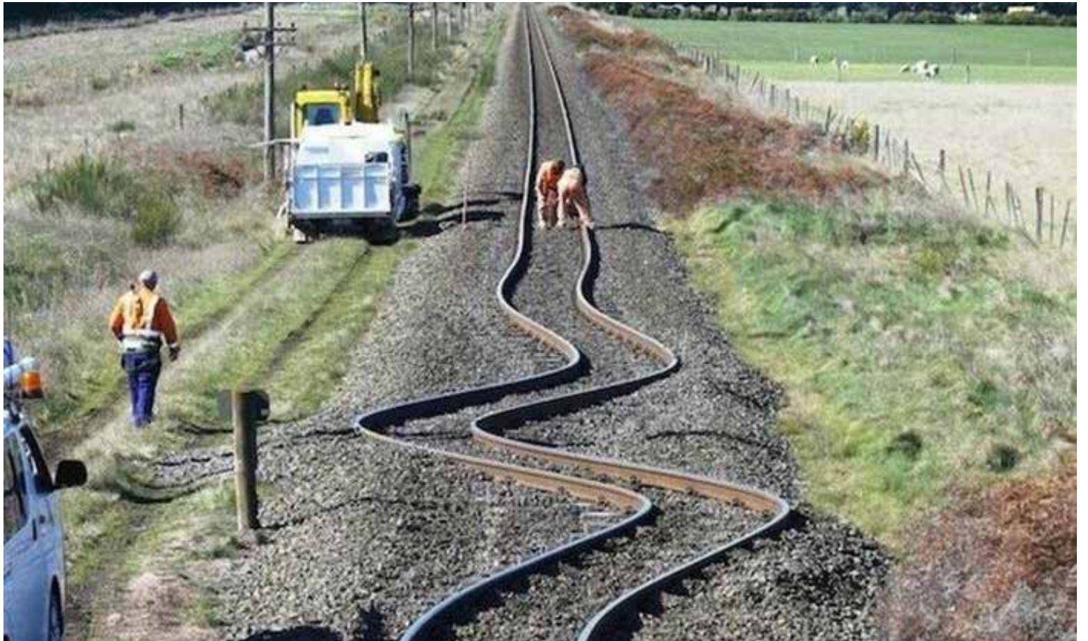
Estas vías de tren no fueron colocadas por una persona ebria. Son el resultado de un terremoto ocurrido en Nueva Zelanda.
