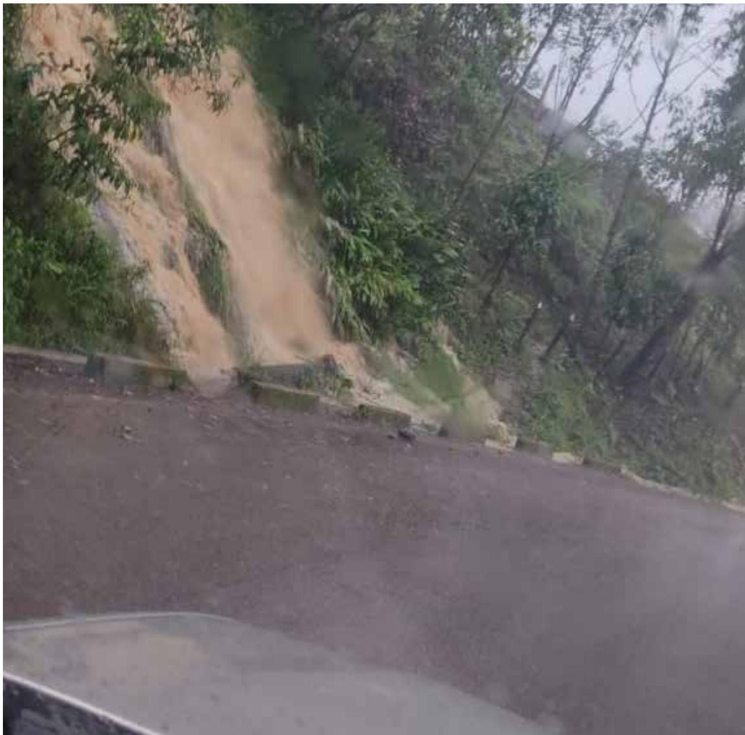
Las fuertes lluvias en el km 58 de la Vía al Llano, jurisdicción de Guayabetal, y en las poblaciones de Ubalá y Medina, bloquearon la carretera.
