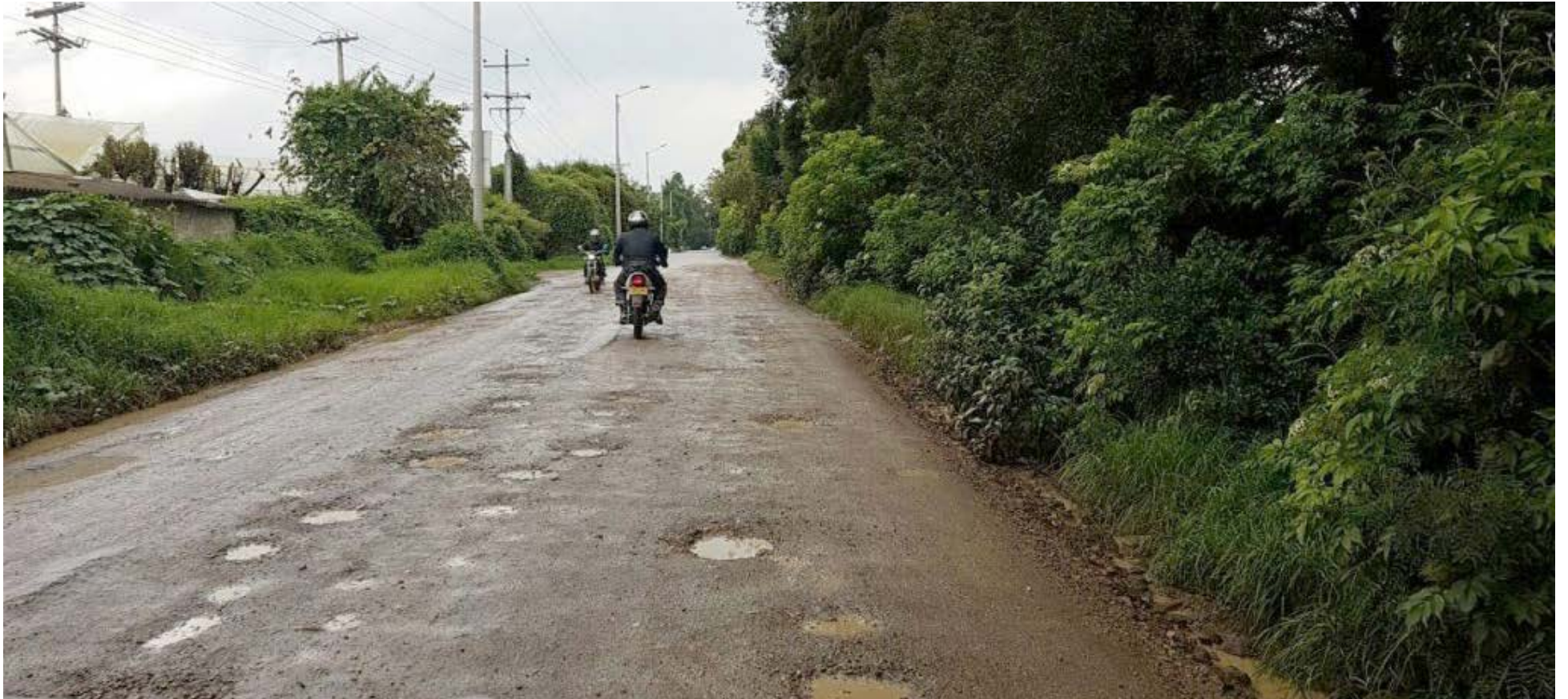
Varias carreteras en Cundinamarca se encuentran en un estado lamentable
