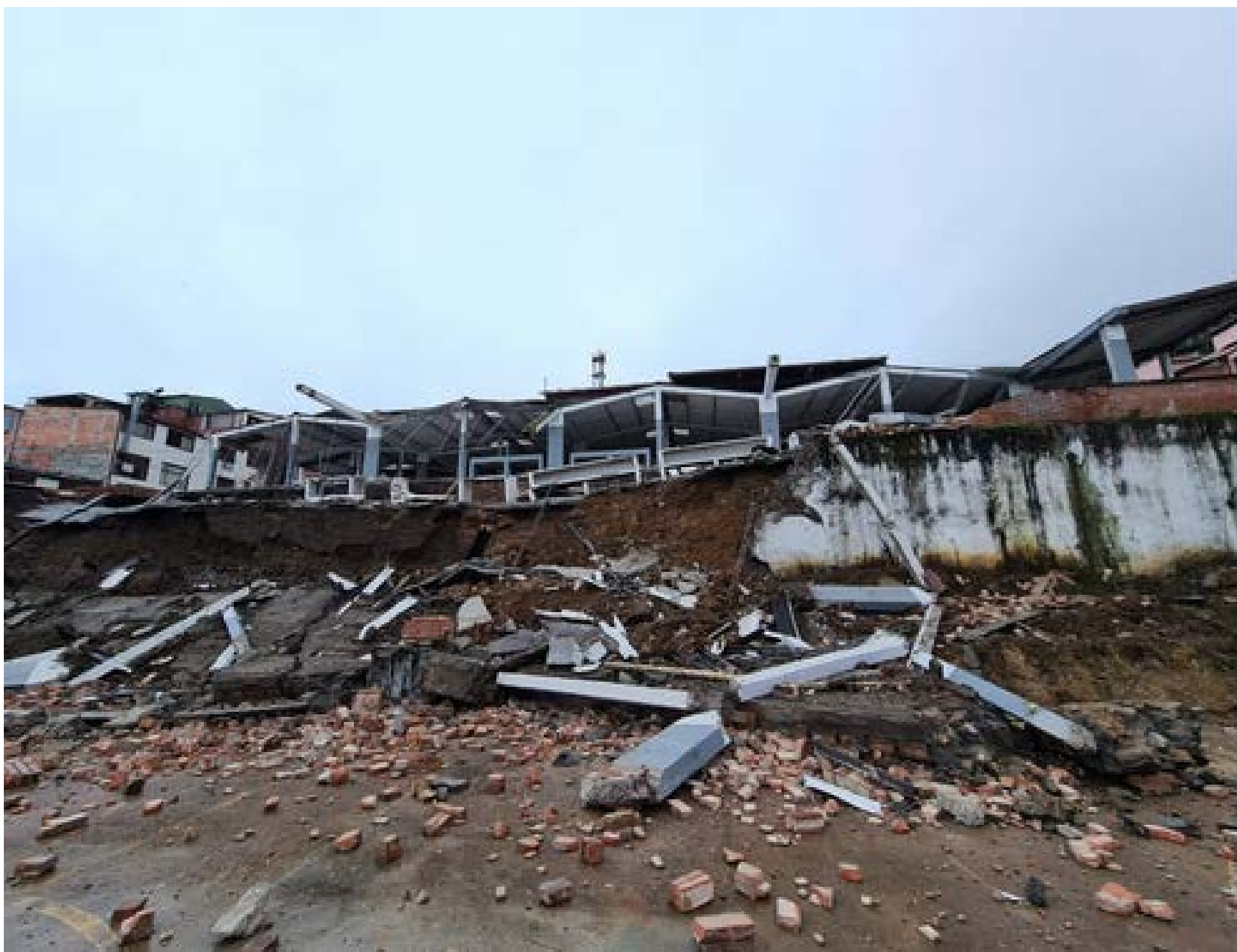
La caída de un muro de contención, originó el desplome de la Plaza de Mercado de Ubalá- Cundinamarca.
