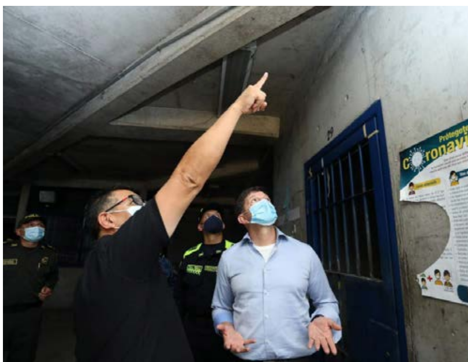
Las fallas donde se filtra la humedad son inspeccionadas y se ordena de inmediato reparación.
