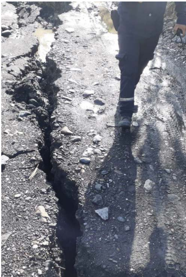
Buena parte de las carreteras colapsaron
