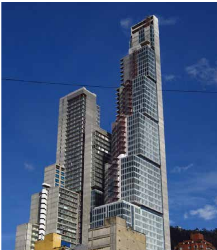
Los pisos de arriba se encuentran en obra negra. El dinero no alcanzó para la construcción de las escaleras de emergencia.
