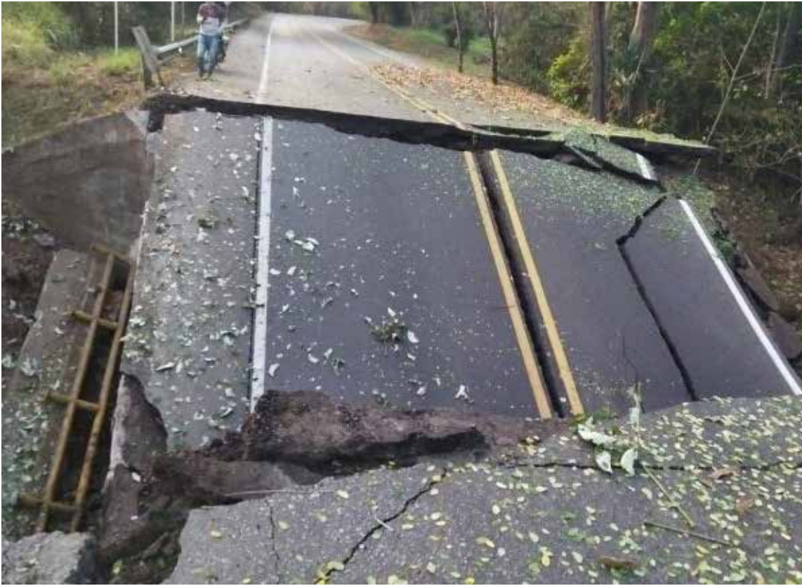
Carreteras fueron objeto de explosivos.
