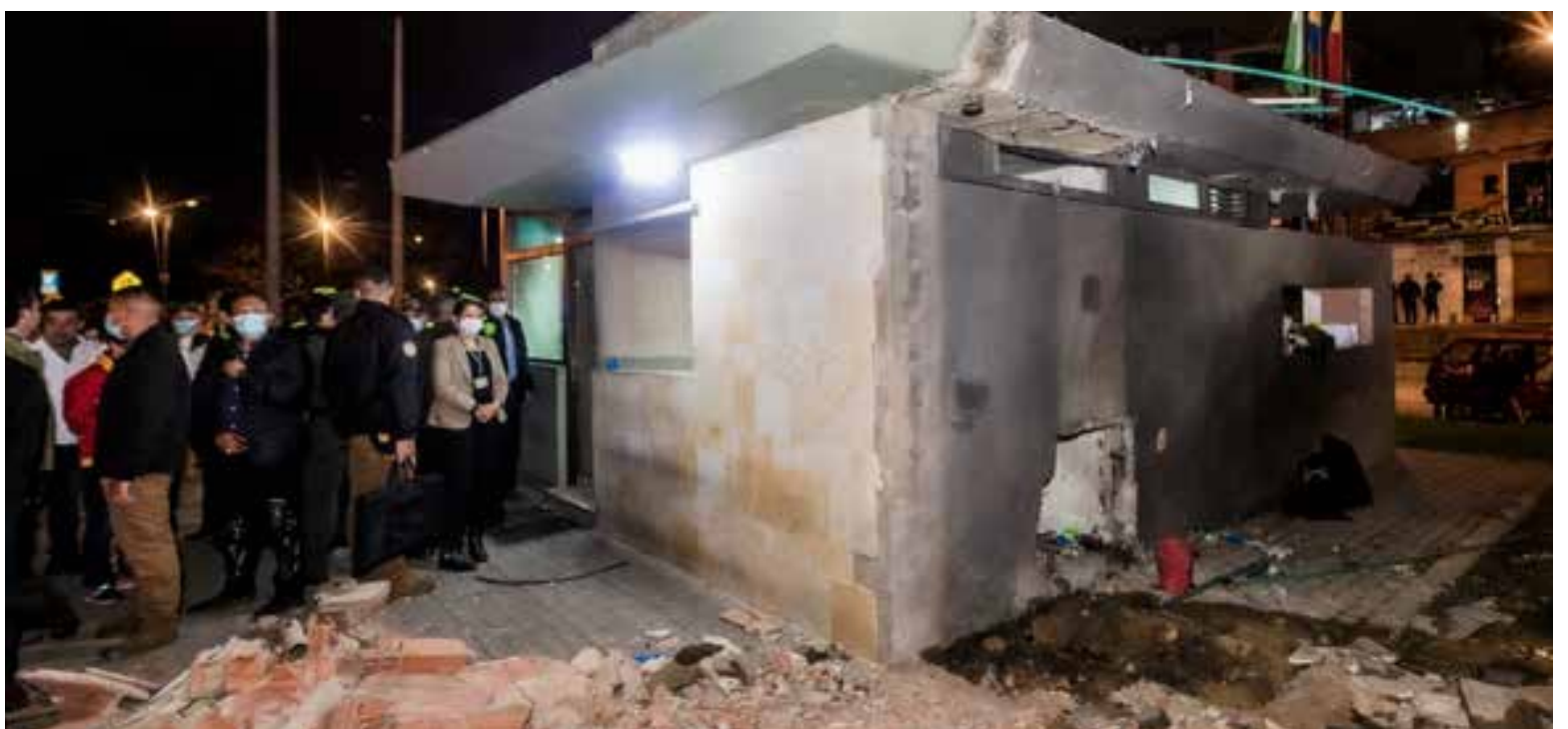
Así quedó la edificación policial después del atentado dinamitero.
