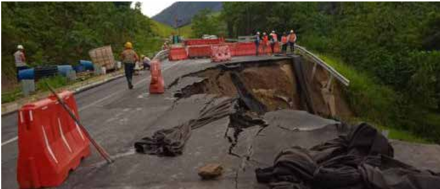
Estado de la carretera en Santander recién estrenada
