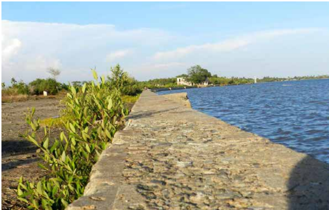
En esa franja costera, lo único que queda intacto de la furia de Paloma es el muro de concreto que protege al litoral costero.
