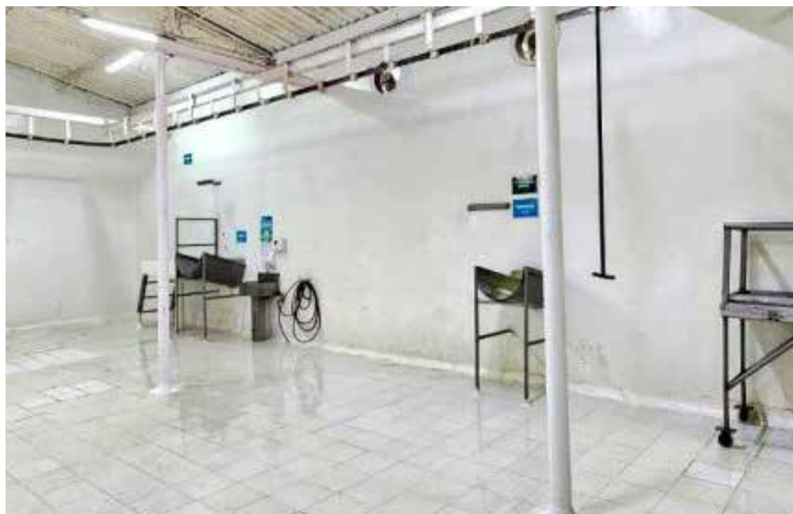
Instalaciones de una planta de tratamiento.
