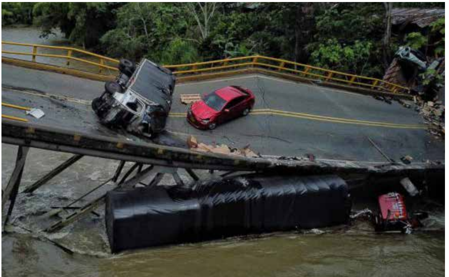
Otro monumento a la corrupción en Colombia. El Alambrado, en la vía que comunica a los departamentos del Valle del Cauca y Quindío, en la autopista del café ha paralizado esta zona del país
