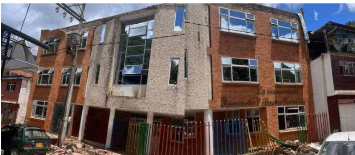
Daños en edificaciones en Cundinamarca
