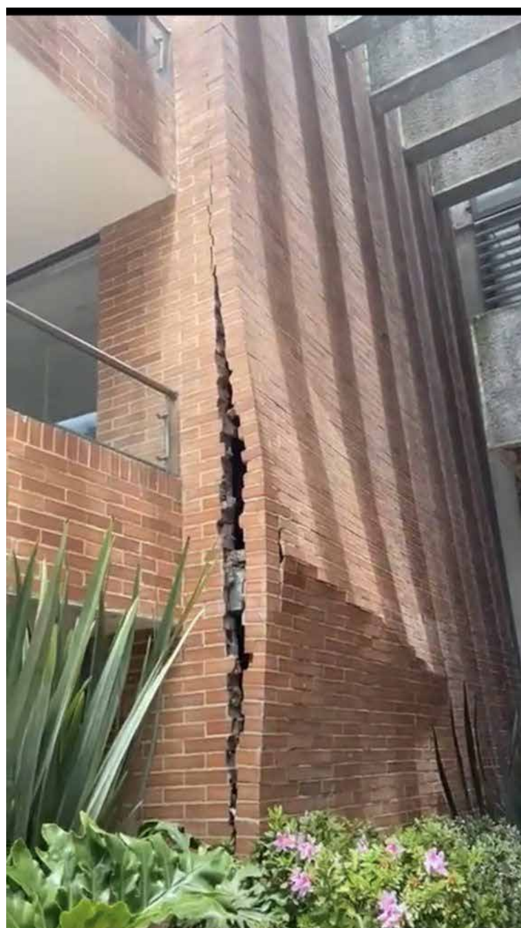
Algunos daños en edificaciones del norte de Bogotá.
