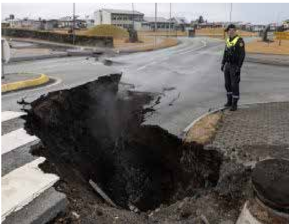
Grietas en la ciudad
